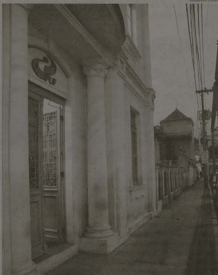
Em frente ao IpuF, o piso colocado de modo errado fica no meio-fio e vai em direção ao poste
