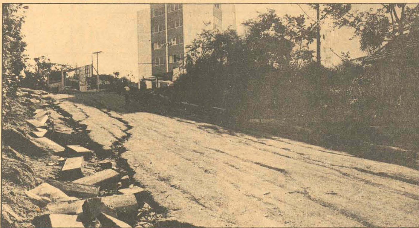
Travessa Madame Jaqueline, na Trindade: Obras abandonadas pela Comcap.
