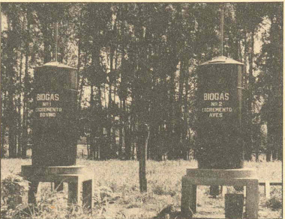
Estes são os digestores que produzem o biogás
