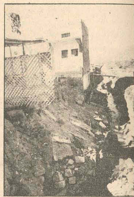
Erosão: culpa da Comcap, segundo Vieira.
