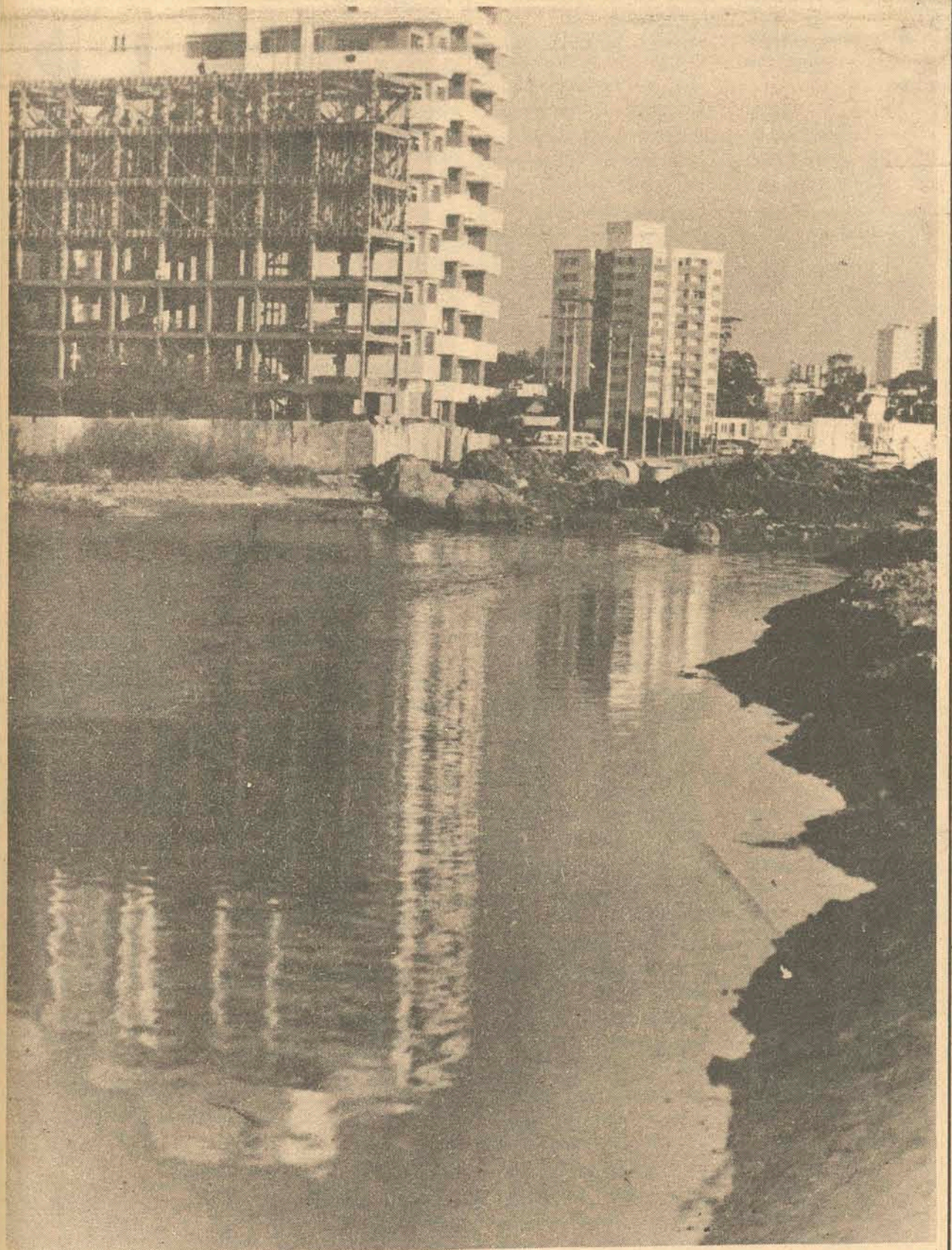
As obras de prolongação da avenida Rubens de Arruda Ramos (Beira-Mar Norte) vão causar transtornos nos edifícios localizados nessa área. O aterro está impedindo a vazão dos dejetos e a Casan não sabe como solucionar esse problema já que as obras da avenida não podem ser paralisadas. (P. 16)
