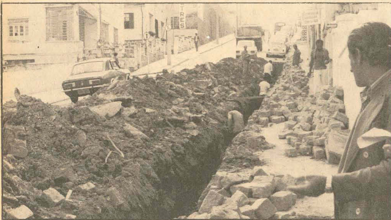
Transformada em depósito de areia e cimento, a rede está sendo desentupida pelos operários. Prejuízos acima de Cr$ 6 mil.
