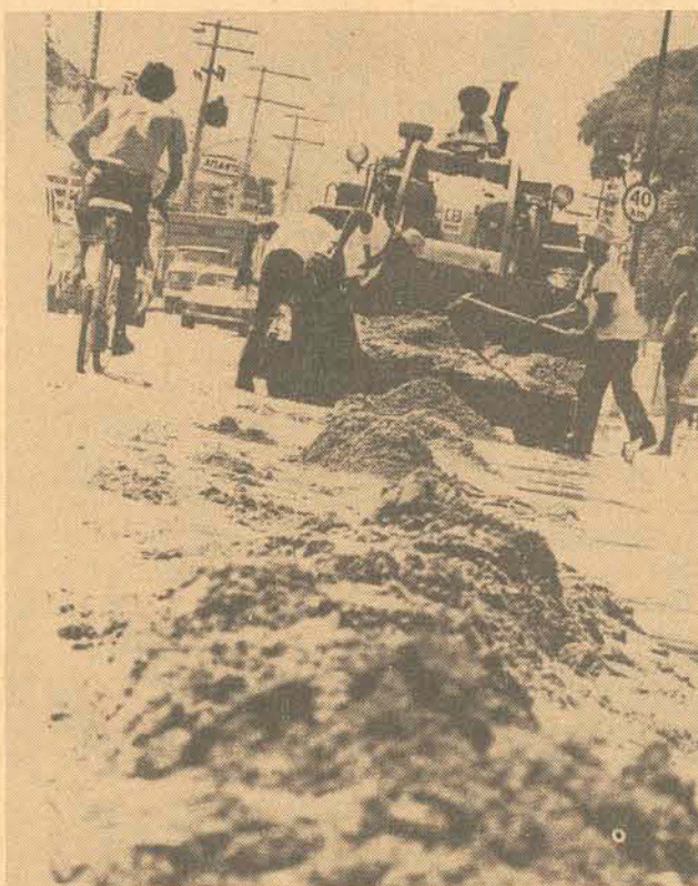
Escassa mão-de-obra para limpeza.
