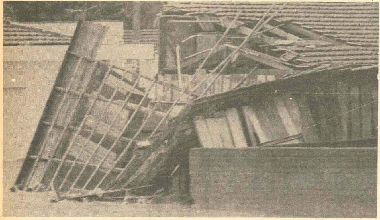
Várias residências do Continente ruíram, porque não resistiram a força das águas
