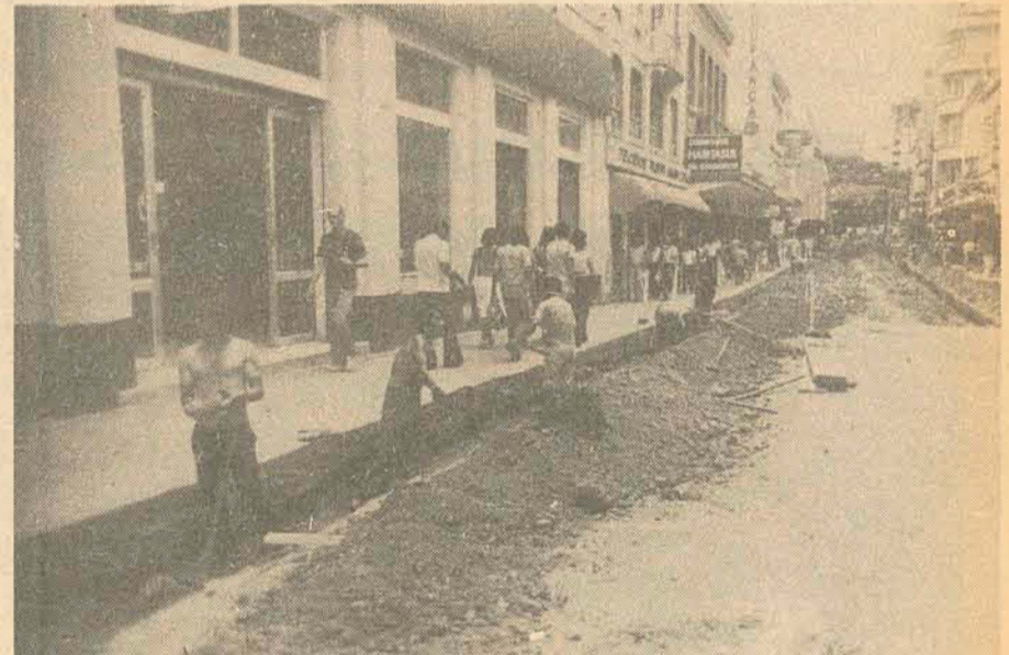
Com 60 homens trabalhando em dois turnos, inclusive aos sábados e domingos, as obras do calçamento da Felipe Schmidt têm prazo de conclusão: 120 dias. A pouca largura da rua impedirá áreas para lazer, servindo apenas para circulação de pedestres (Página 16).
