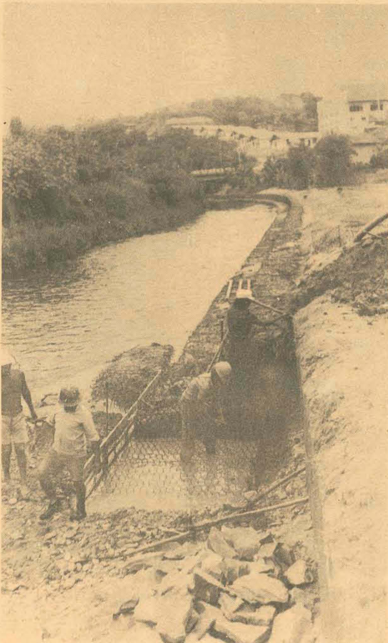
À ESQUERDA FABRICAÇÃO E COLOCAÇÃO DE GABIÕES PARA PROTEÇÃO DAS MARGENS DOS RIBEIRÕES. CUSTO: CR$ 1.662.073,30
