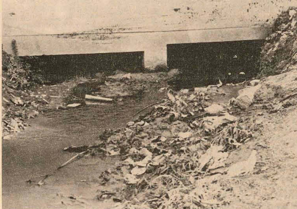
Com os detritos, o leito do rio diminui, prejudicando o escoamento da água.
