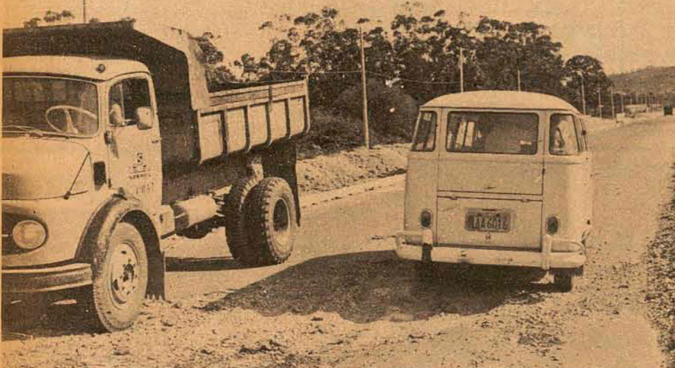
Além do enorme buraco, falta concluir a rua, no fim, perto da rua geral da Trindade.
