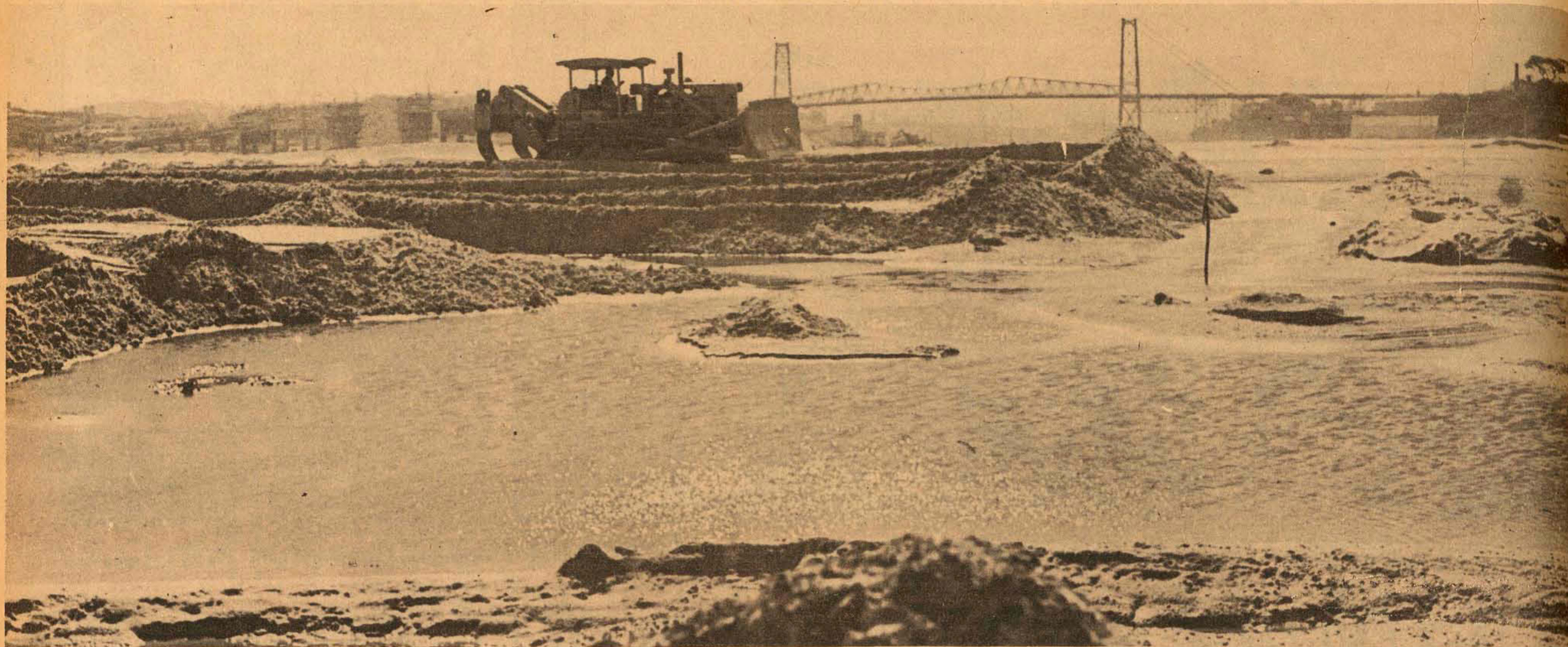
A existência de bolsões de lama sob o aterro estaria tornando permeável o solo acrescido à Ilha, onde será construído o sistema viário anexo a uma nova ponte Ilha-Continente.
