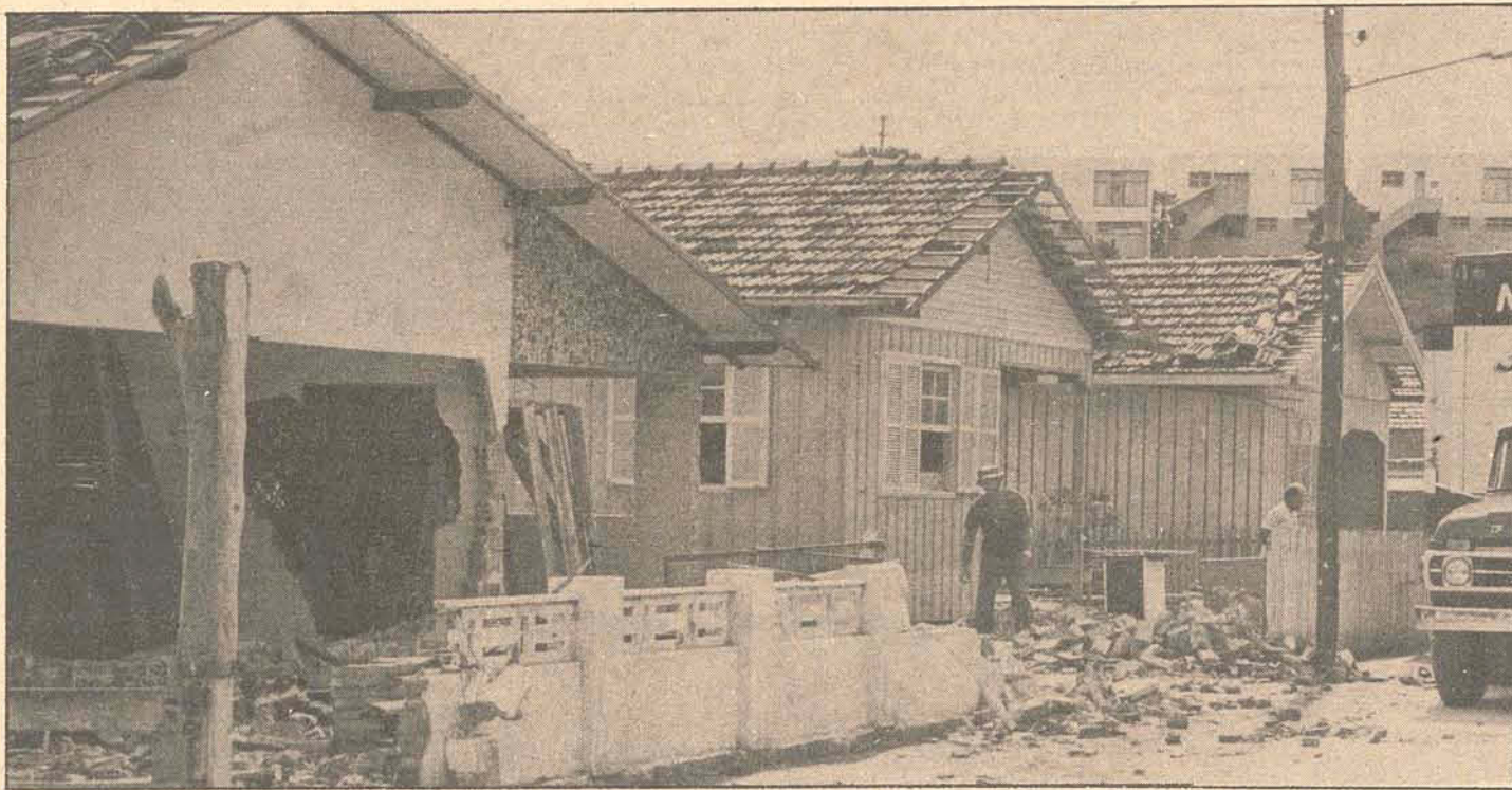
As amplas avenidas que estarão perfazendo em breve os novos acessos à ponte nascerão na esteira das demolições da área desapropriada
