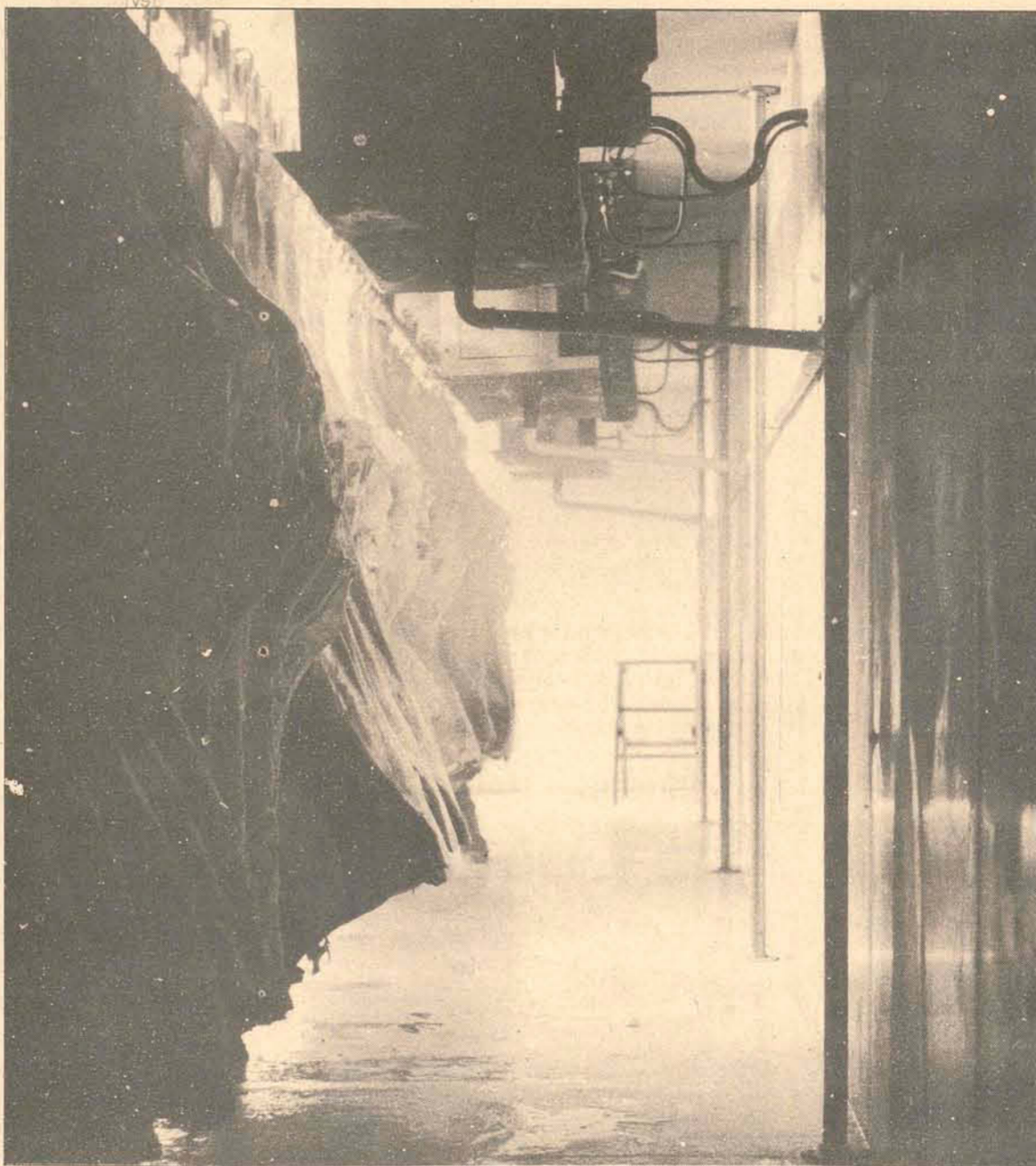
Vista interna da câmara frigorífica
