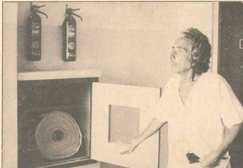
Nem mesmo os zeladores estão treinados para usar o extintor de incêndio.
