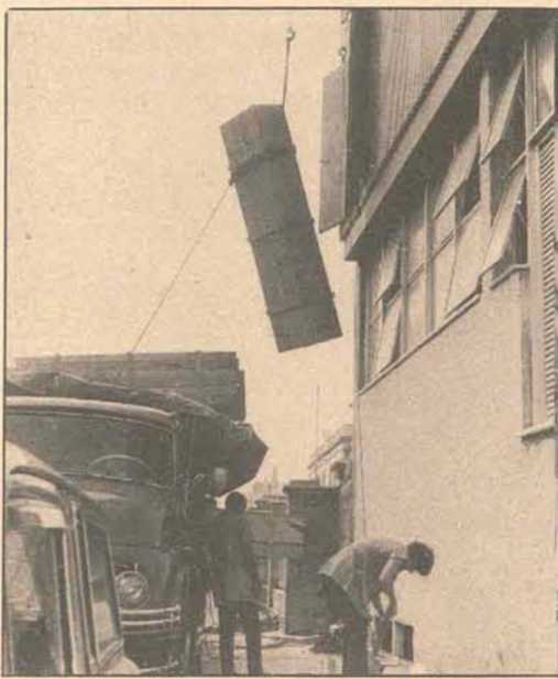
O equipamento da nova Central, dos mais modernos, sendo descarregado na semana passada.
