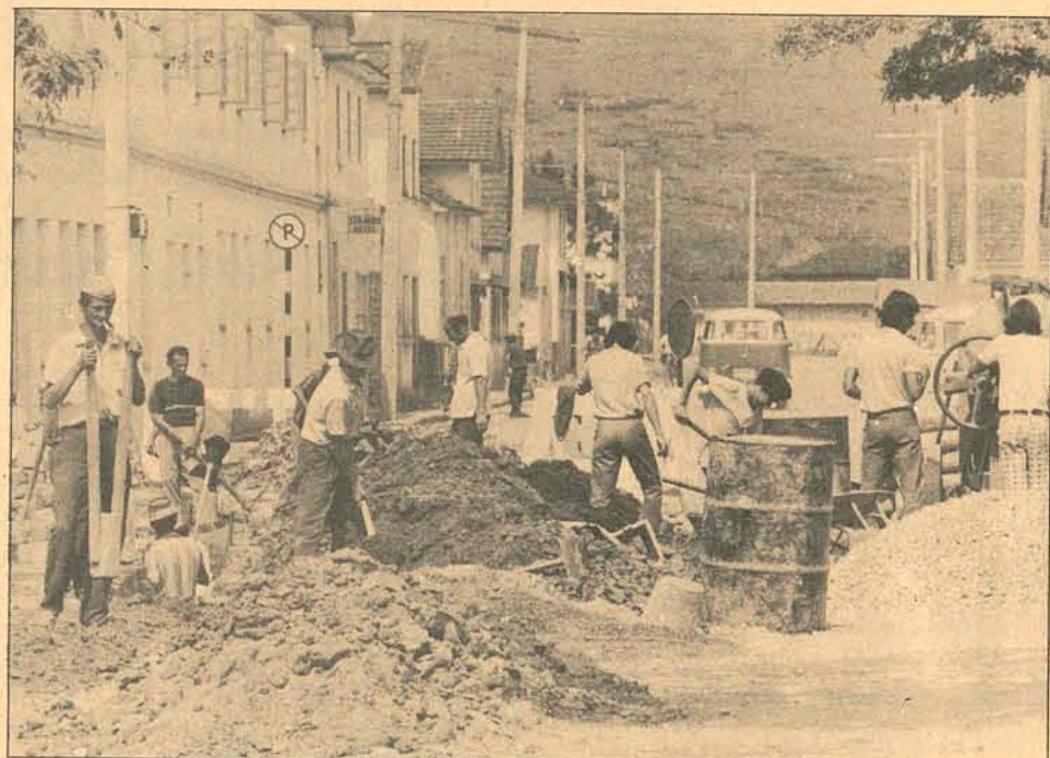
A rede subterrânea de Brusque, com cerca de oito quilômetros, terá 2.900 pares telefônicos e estará concluída em nove meses.
