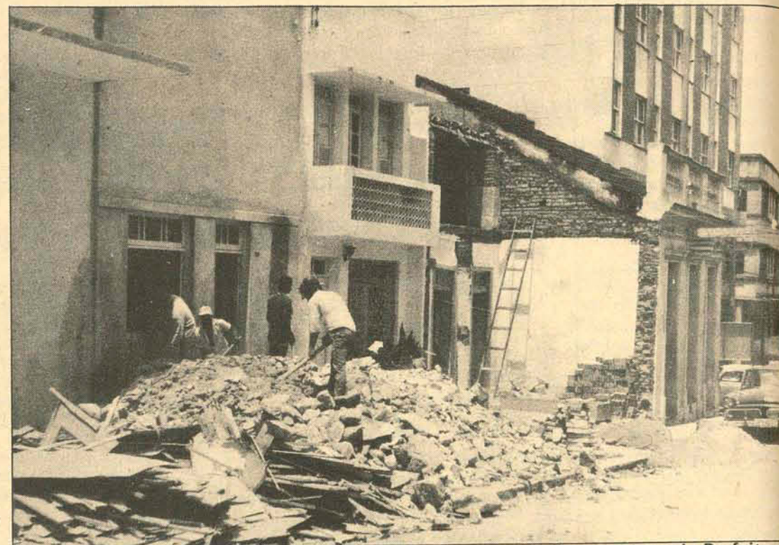
A rua Nunes Machado está sendo alargada. Quatro casas serão recuadas pela Prefeitura.
