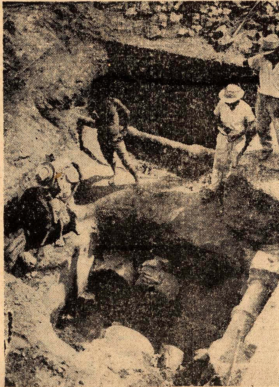
Continua causando transtornos o buraco na rua Conselheiro Mafra, próximo à redação de O ESTADO. Há vários dias a Prefeitura realiza obras no local e os serviços estão atrasados face à necessidade de um prazo dilatado para a secagem do concreto.
