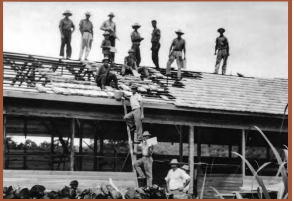
Cobertura da Escola Isolada do Gaspar Grande, em 1964. Em baixo: Olímpio Moretto ajudando na obra.
