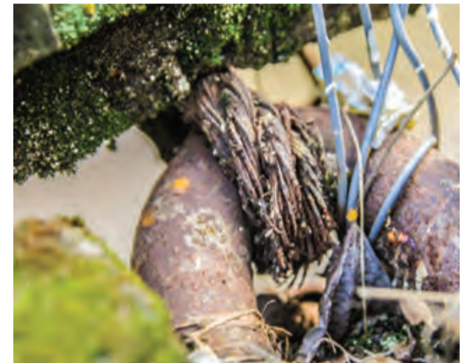
SITUAÇÃO é precária e cabos de aço estão enferrujados
