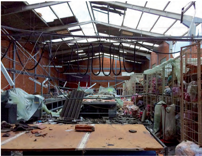
Confecção no Santa Terezinha teve estrutura danificada
