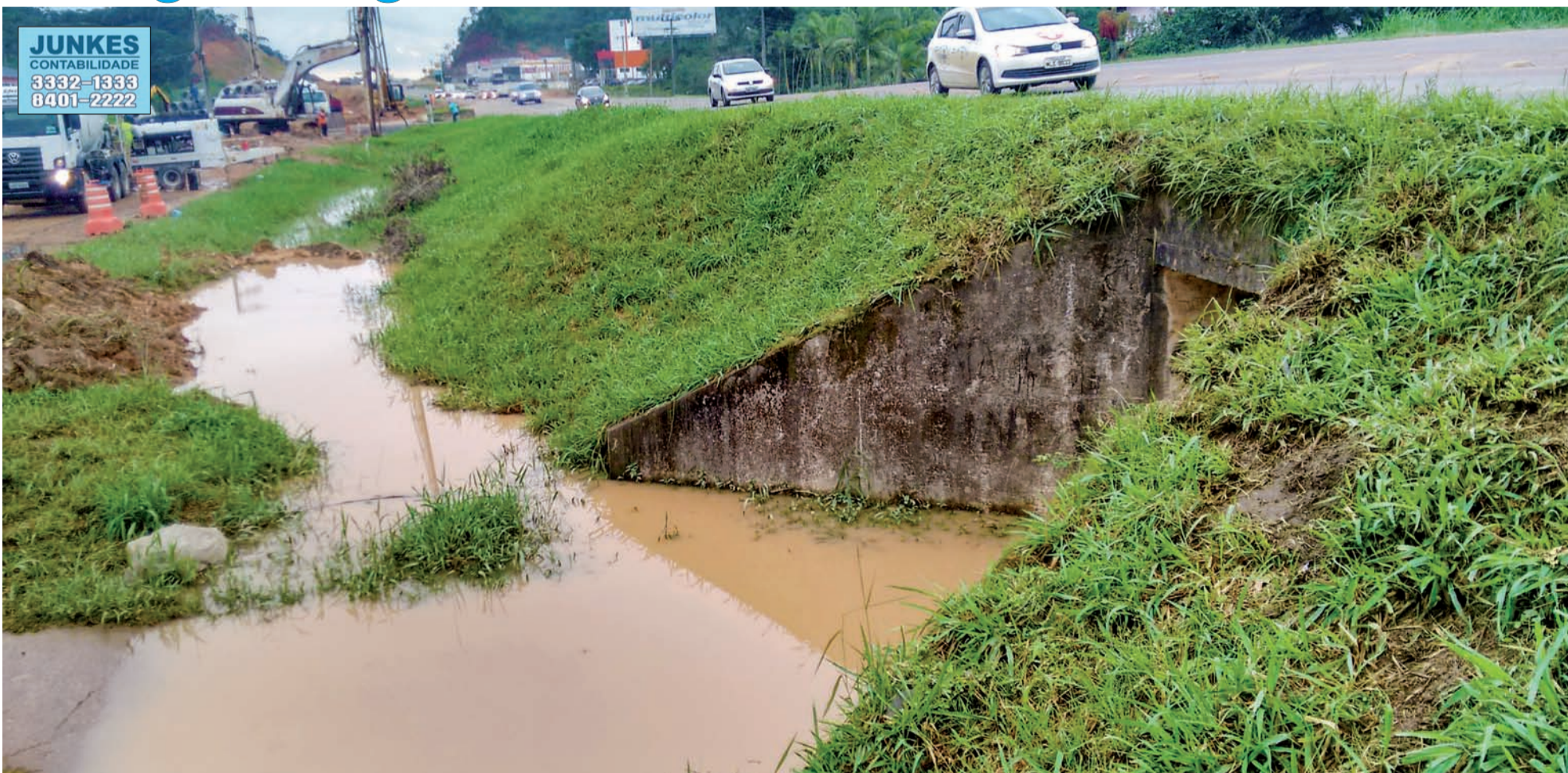
Passagem que liga Sertão Verde à Margem Esquerda está alagada desde 12 de dezembro, quando caminhões que realizam a duplicação da BR quebraram canos no local. Agora, moradores passam pela água ou atravessam a rodovia correndo risco de se envolverem em acidente.
