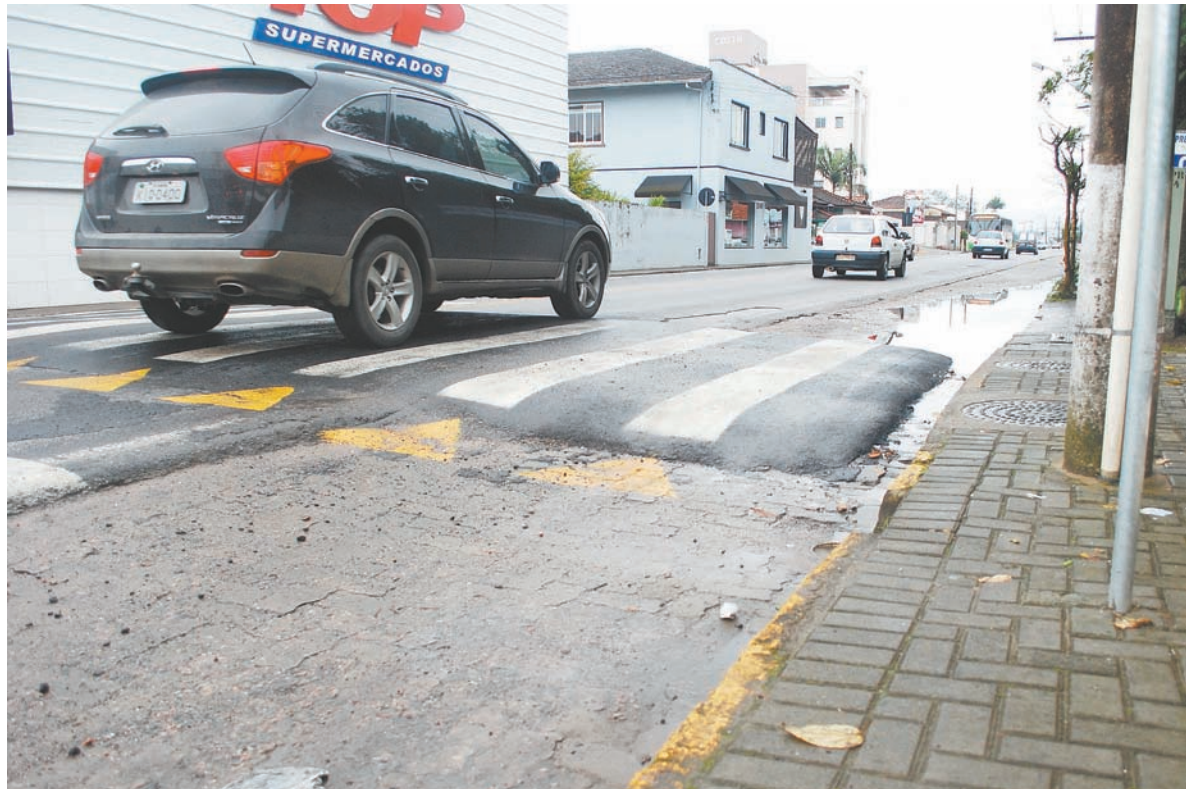
NA rua Nereu Ramos, asfalto da travessia elevada não segue até a calçada, onde falta o piso tátil
