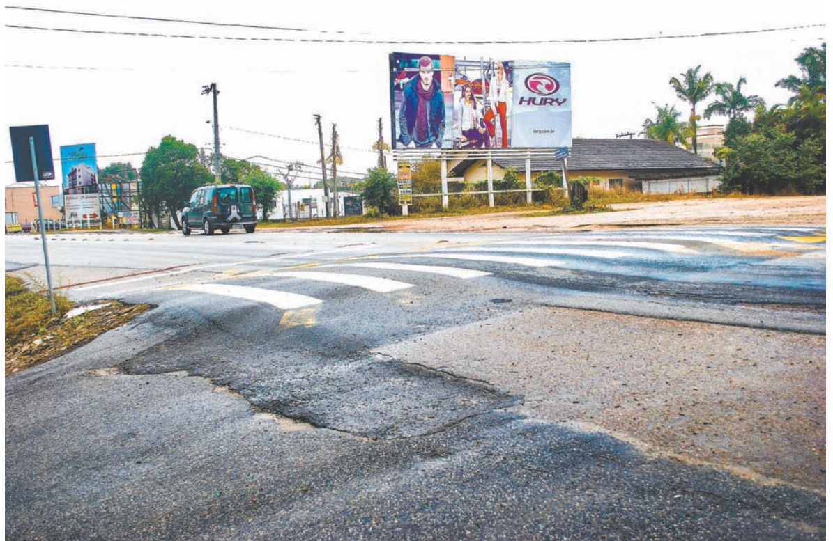
PRÓXIMO ao acesso da localidade Águas Negras, travessia não é plana e acaba em uma descida
