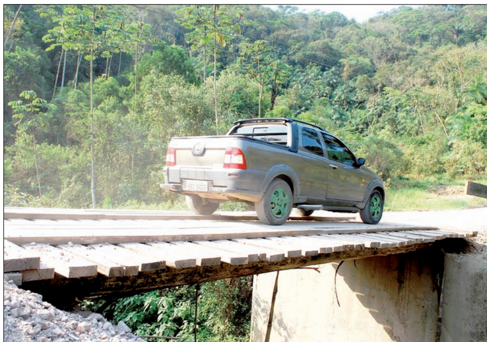
ESTRUTURAS são vistas com maior frequência no Gaspar Alto e Belchior
