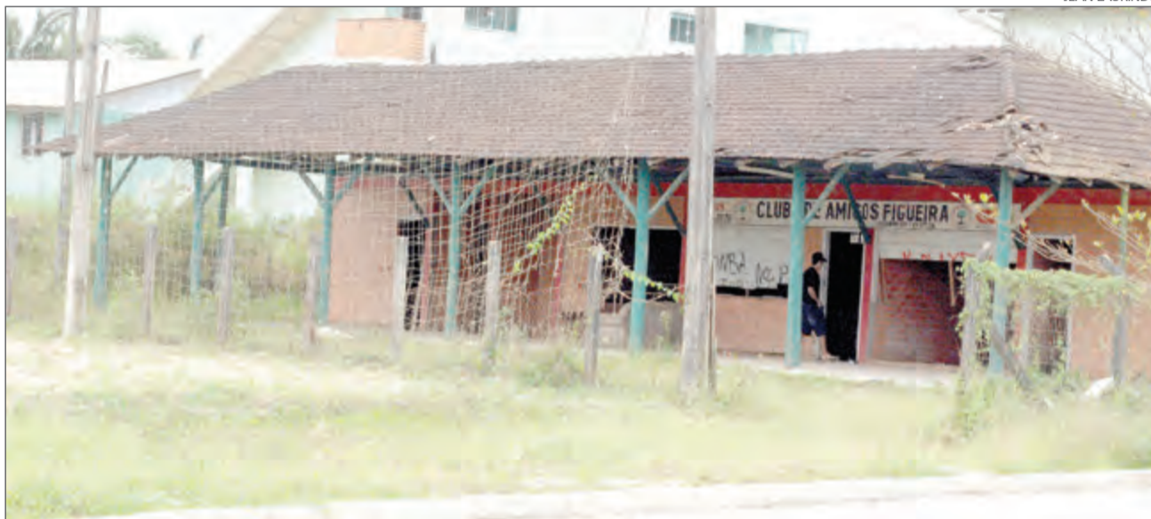
SITUAÇÃO prejudica comunidade, mas ainda não há perspectiva para demolição nem para início das obras
