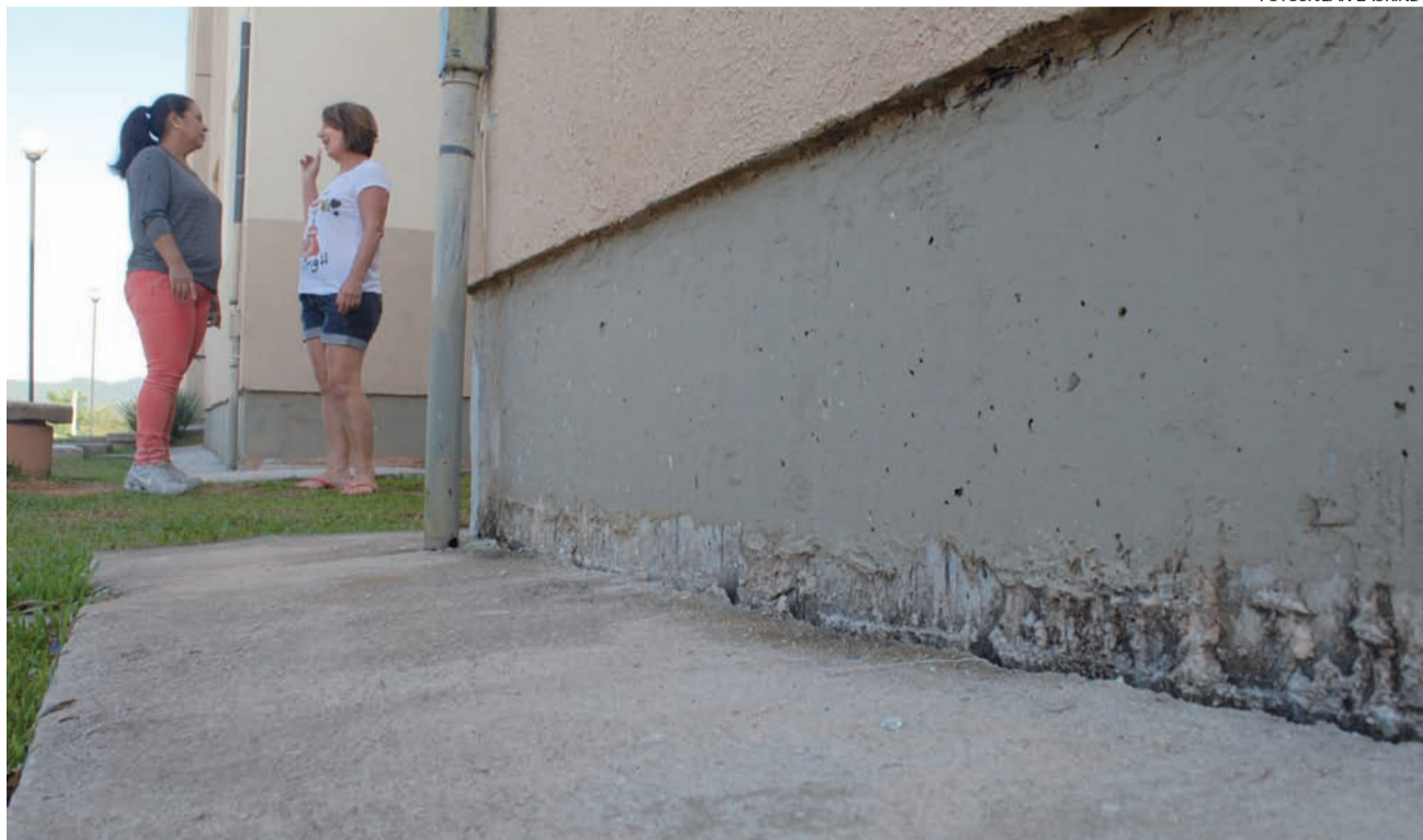
FAMÍLIAS do residencial Milano convivem com problemas como ferro aparente, rachaduras e casos de vazamento
