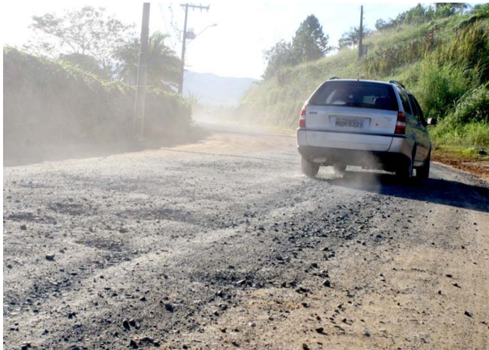
COM buracos à vista nas ruas centrais, comunidade espera que pavimentação saia do papel
