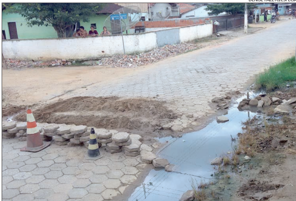
MORADORES vala no meio da rua para escoamento do esgoto. Prefeitura foi ao local e fechou
