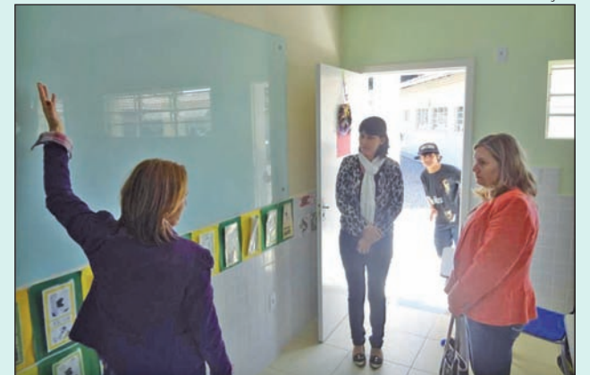
Altura dos quadros inadequada para alunos e professores
