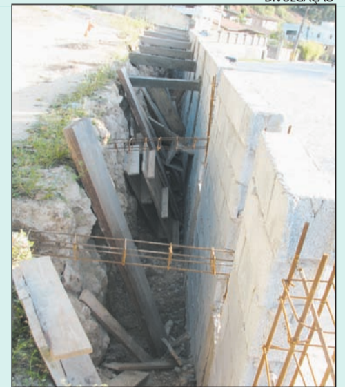
Este é o vão que querem aterrar sem drenar
