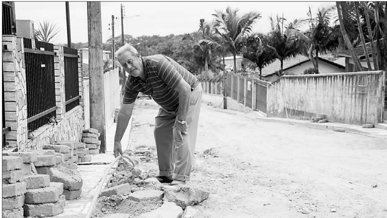
SEU Raulino mostra novos canos que foram instalados para abastecer a comunidade de água e que segundo ele estouram com facilidade
