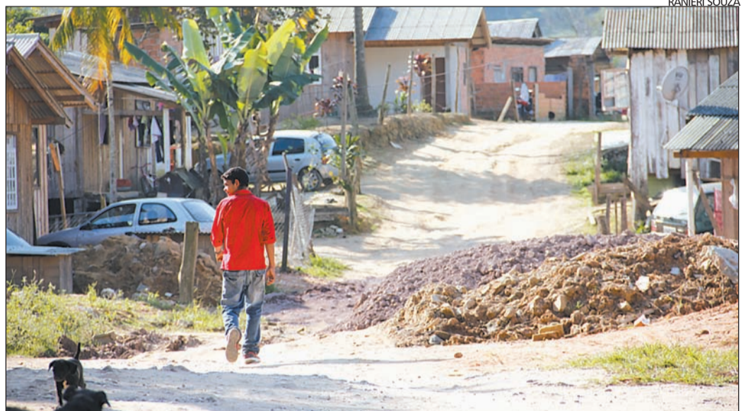
NOVAS ruas serão abertas e todas as vias serão pavimentadas e terão novas calçadas, com acessibilidade
