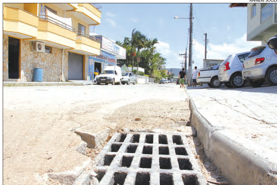
PROBLEMA do mau cheiro incomoda moradores do bairro desde início das obras de drenagem pluvial
