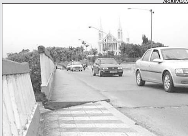
CABECEIRA da Margem Esquerda está cedendo desde 2010
