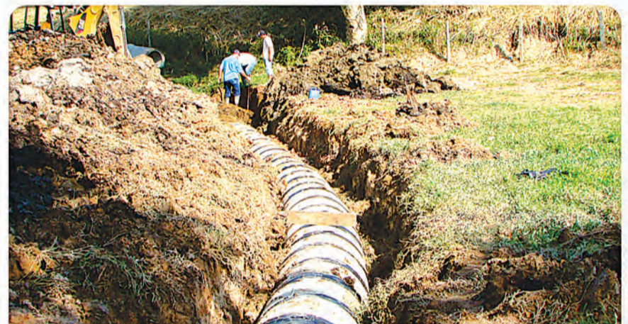
3 Tubulação evita alagamentos - Av. Frei Godofredo
