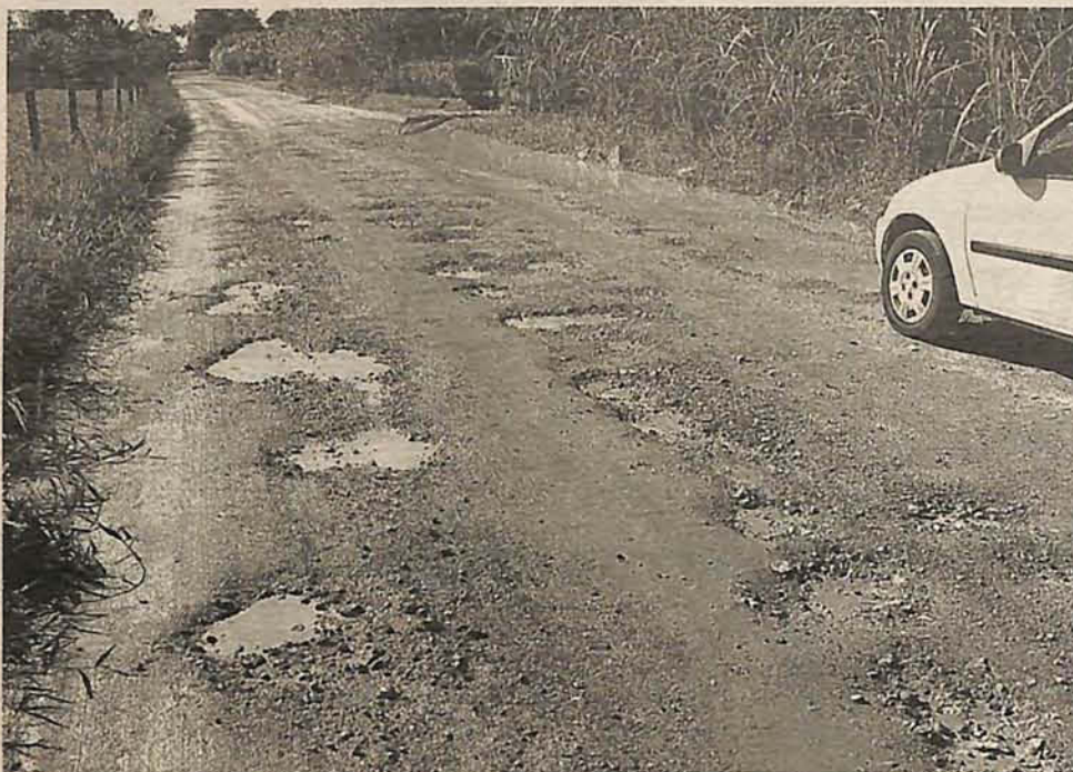
CONDUTORES precisam reduzir muito a velocidade para desviar dos inúmeros buracos do local
