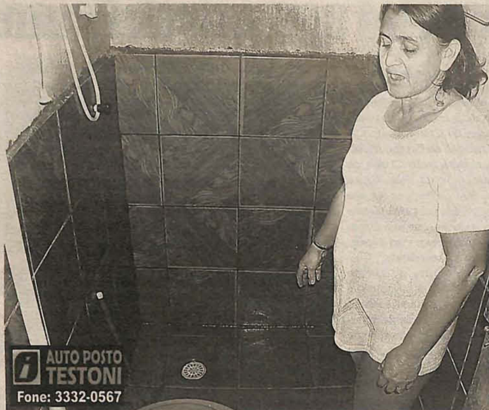
MARIA FRANCISCA mostra o grave problema ocasionado com a tubulação que está entupida
