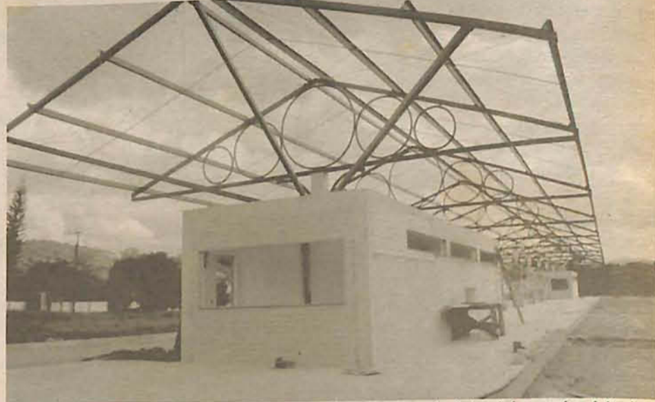
Rua José Honorato Müller, que passa em frente ao terminal, também será asfaltada
