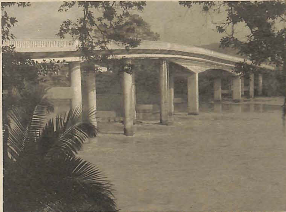
Estrutura da ponte está comprometida e manifestação vai interditar o trânsito no local
