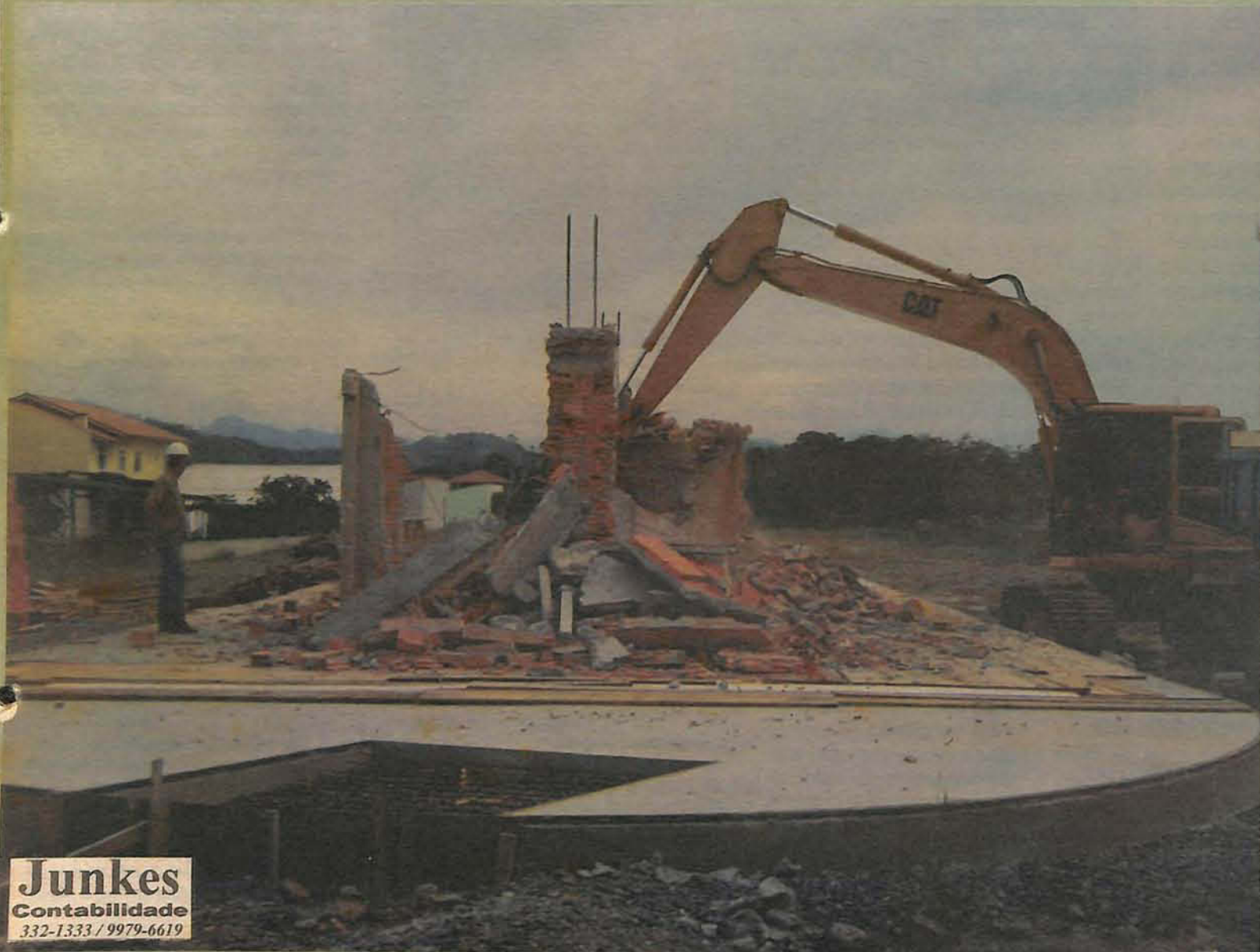
Obra do novo Terminal Municipal Urbano, com problemas de segurança, foi reduzida a um monte de tijolos e ferro retorcido.
