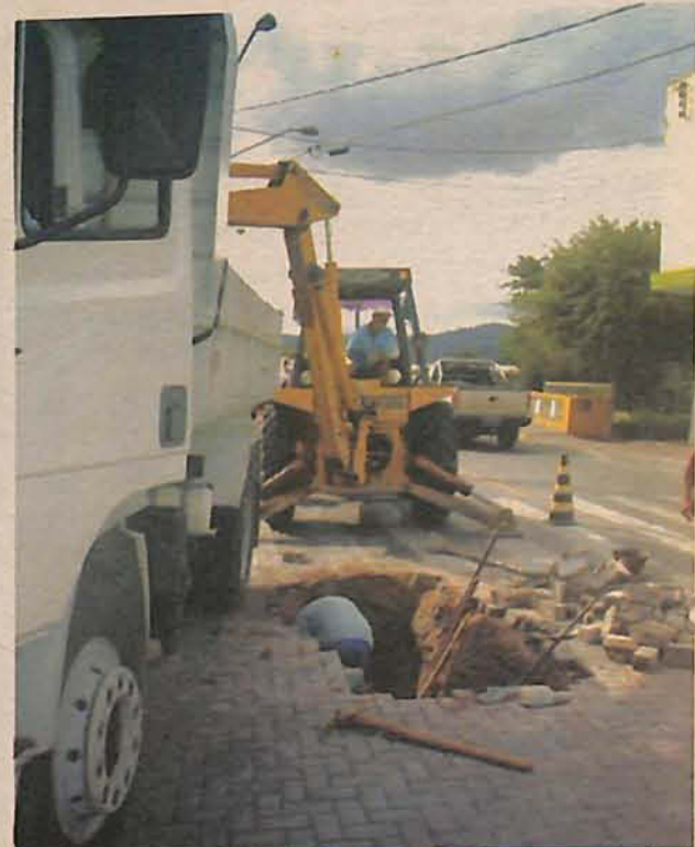
Rompimento de outra tubulação causou apreensão
