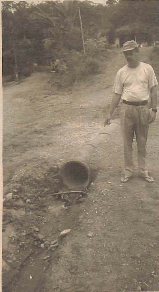
Problema se arrasta há muitos anos, sem que as administrações públicas resolvam o problema. Os moradores exigem uma medida eficaz por parte da Secretaria de Obras
