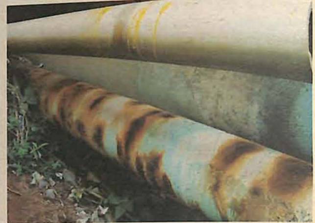
Falhas na tubulação podem interromper abastecimento
