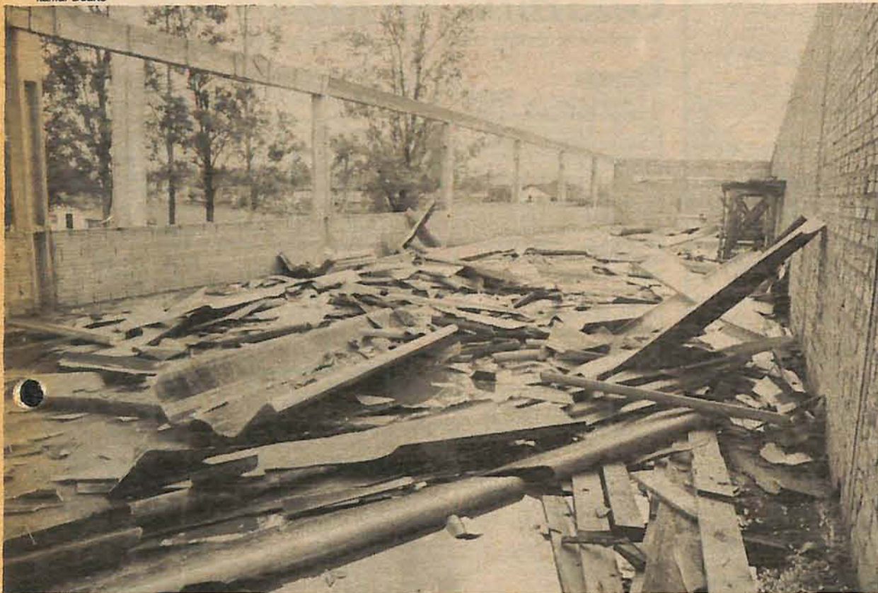
Calhetões da cobertura da nova sede do Tupi destruídos pelo vendaval. Prejuízo passa dos Cr$ 40 milhões.
