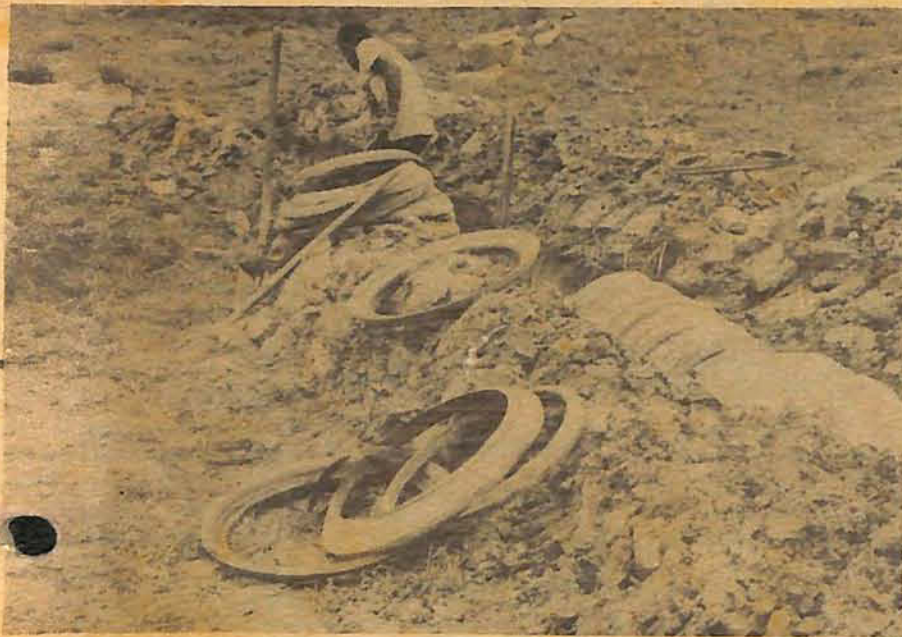
Obras são feitas em desacordo com a legislação vigente. A drenagem é...
