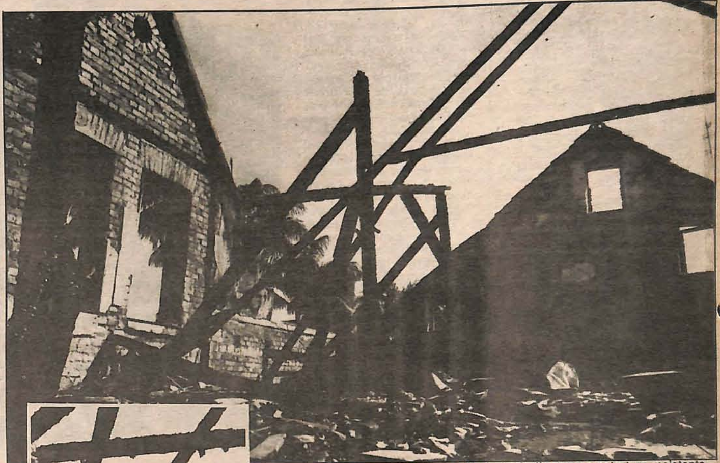
Internamente não sobrou nada do incêndio, mas a estrutura resistente das paredes principais está intacta e pode ser aproveitada
