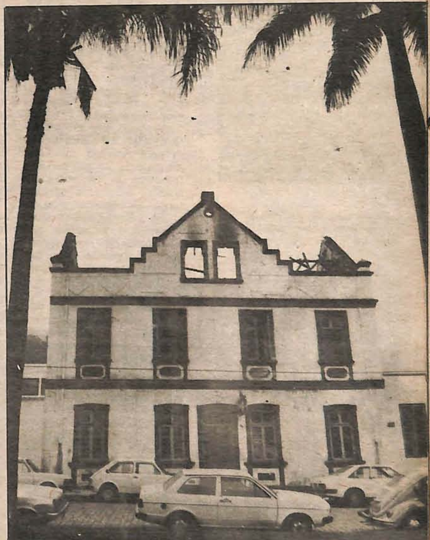
A bonita fachada do Hotel Oliveira, do final do século passado, vai voltar a brilhar
