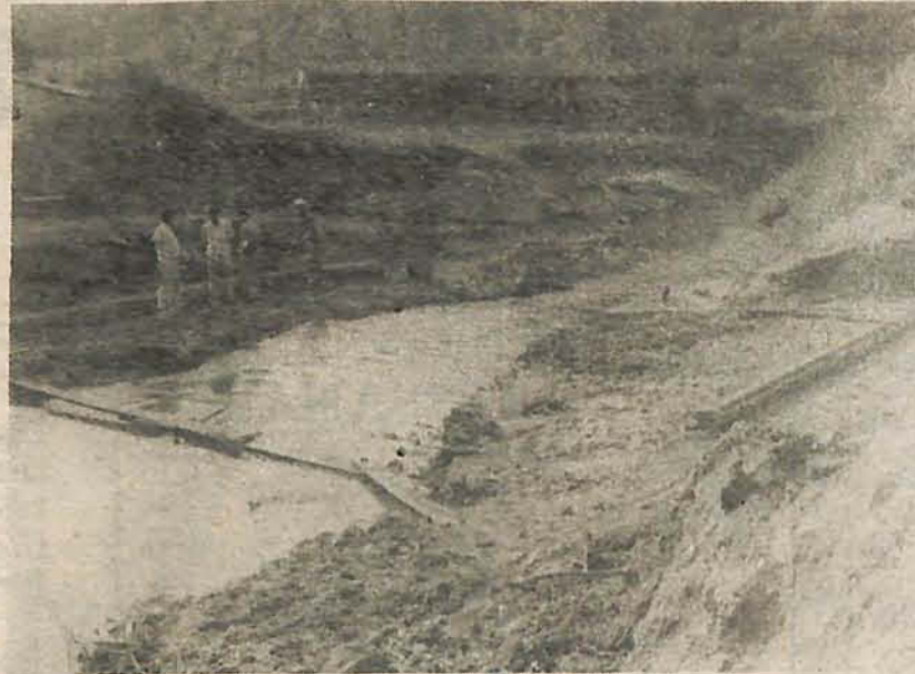
A estrutura será instalada no local onde se encontra o grupo de homens
