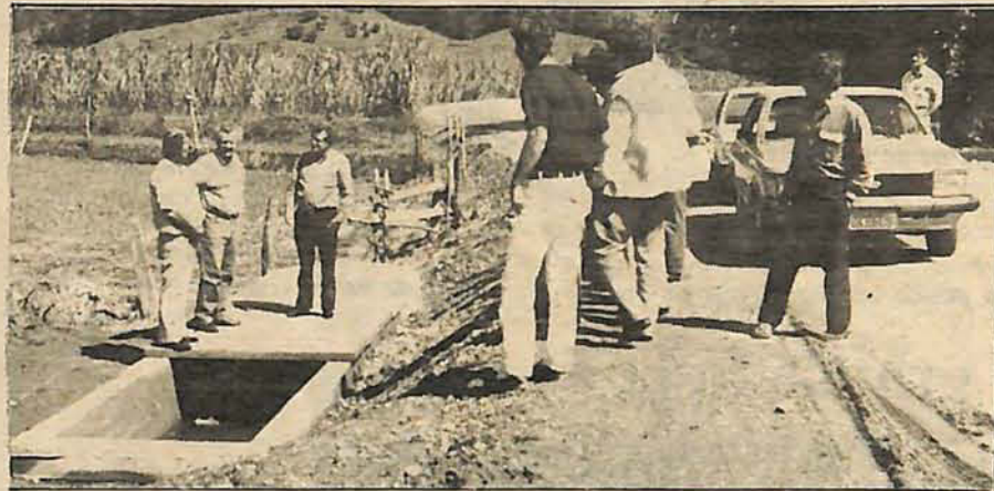
Obra realizada pela prefeitura no Arraial Baixo. Retificação de valas e tubulação para controle a canalização de água para as lavouras de arroz.
