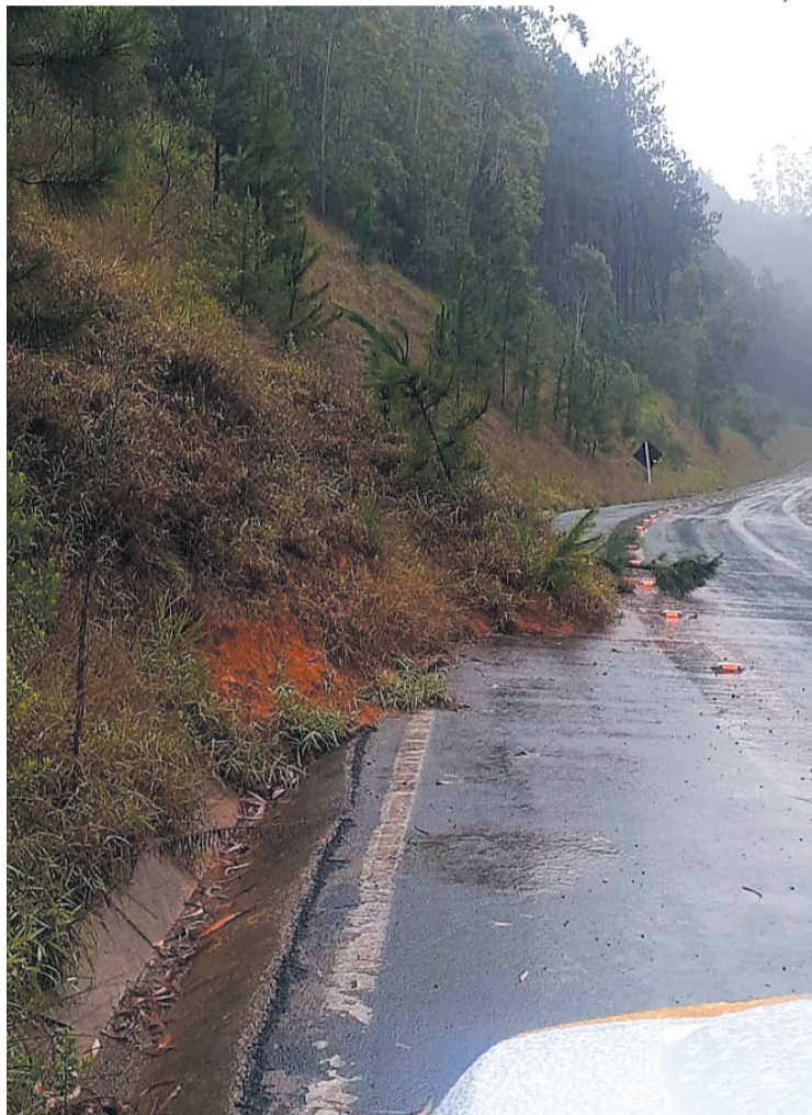
Deslizamento na SC-477, em Dr. Pedrinho (PRE)
