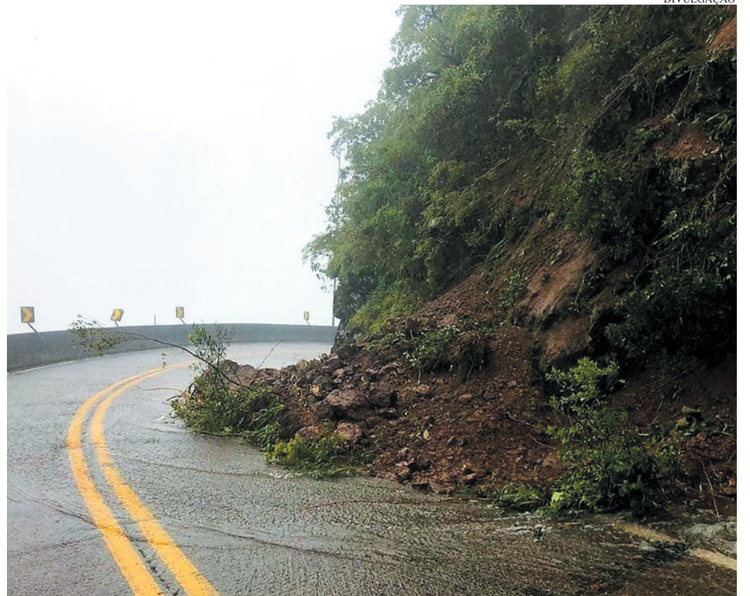
Deslizamento na Serra do Rio do Rastro
