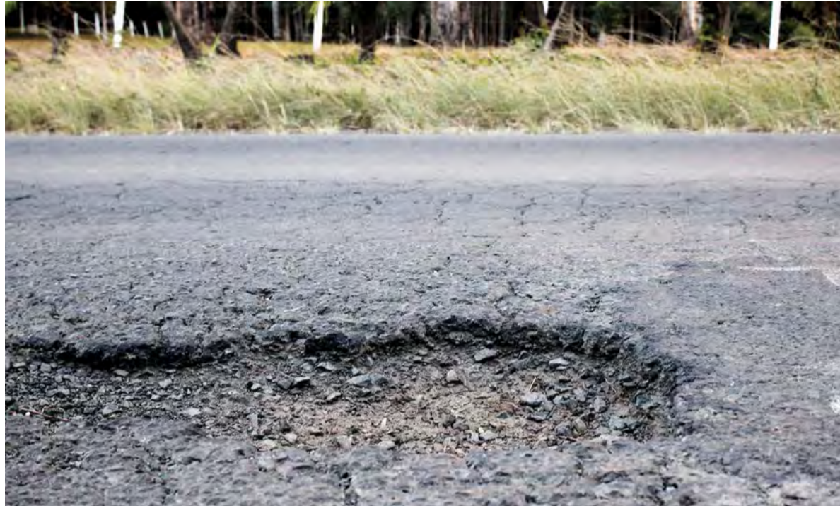
Situação da rodovia coloca em risco os usuários
